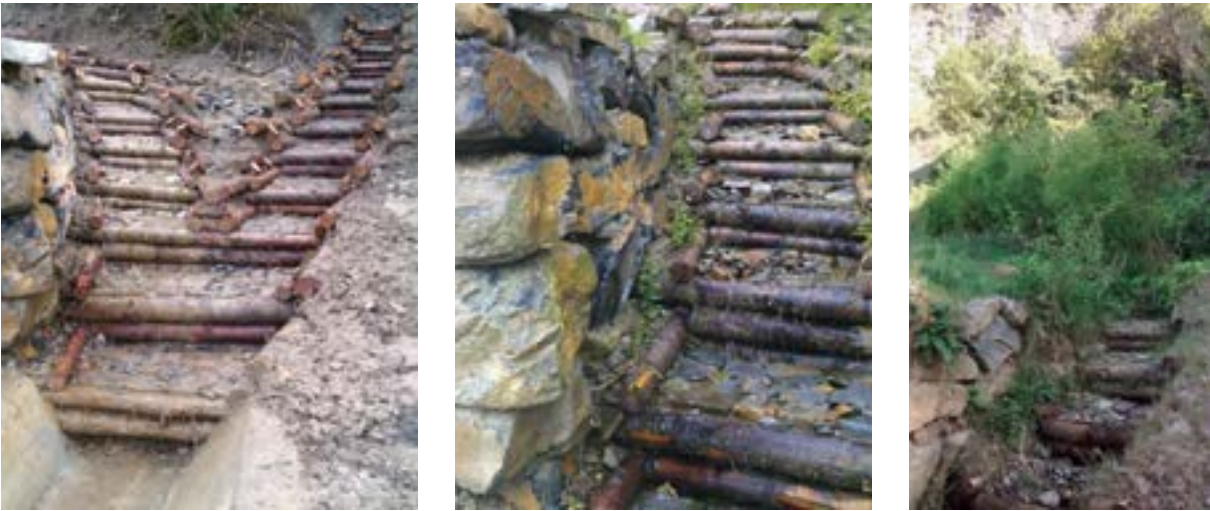
Imagen 179. Bajante en piedra y madera. Adaptación de la cuneta con saltos y su evolución en el tiempo. Fuente: P. Sangalli - SCIA S.L.
